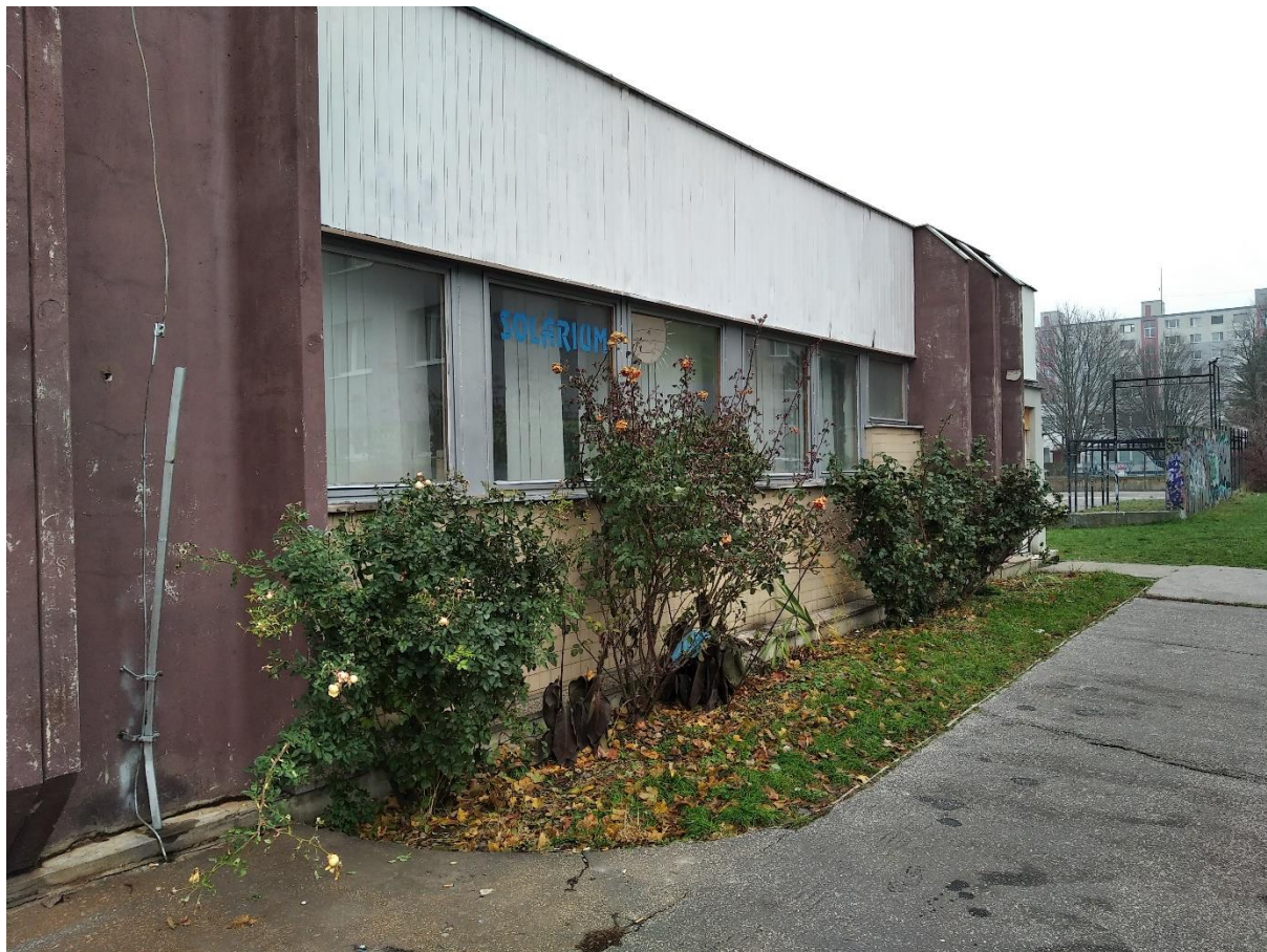
Južná strana budovy – pôvodné okná, nevyhovujúci stav bleskozvodov na celej budove
