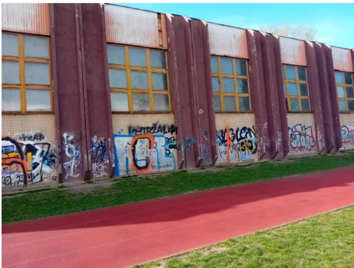
Severná strana budovy – pôvodné okná a nevhovujúci stav bleskozvodov
