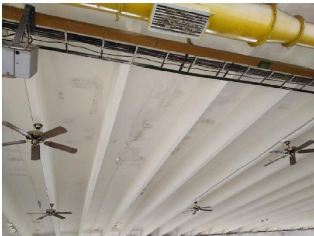
Původní vzduchotechnika doplněná o podstropné ventilátory
