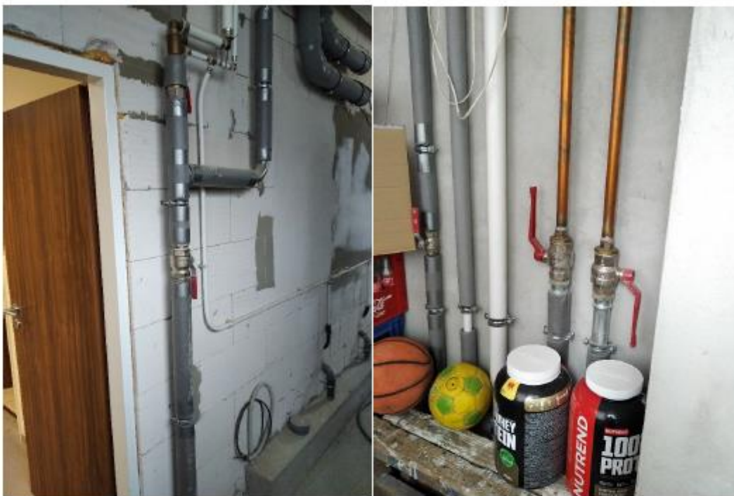
Termostatické hlavice, časť nových rozvodov ÚK a TUV
