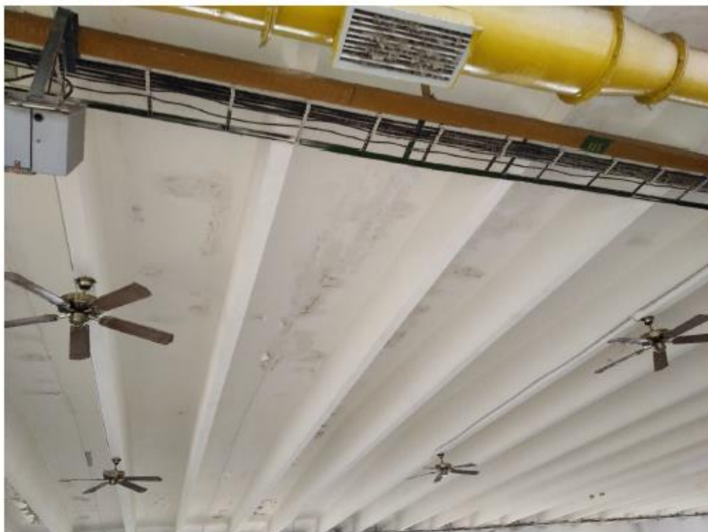
Původní vzduchotechnika doplněná o podstropné ventilátory
