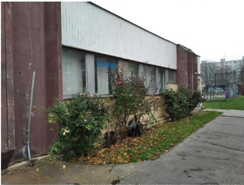
Južná strana budovy – původné okná, nevyhovující stav bleskozvodov na celej budove
