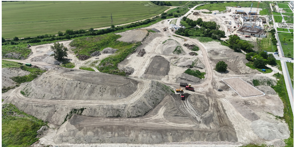
Pri recyklácii hmoty kopca sa oddeľuje opätovne použiteľný materiál (recyklovaná zemina a kamenivo, recyklovaná stavebná suť a betónový recyklát) od ostatného odpadu. | Foto: Tereza Kopecká
