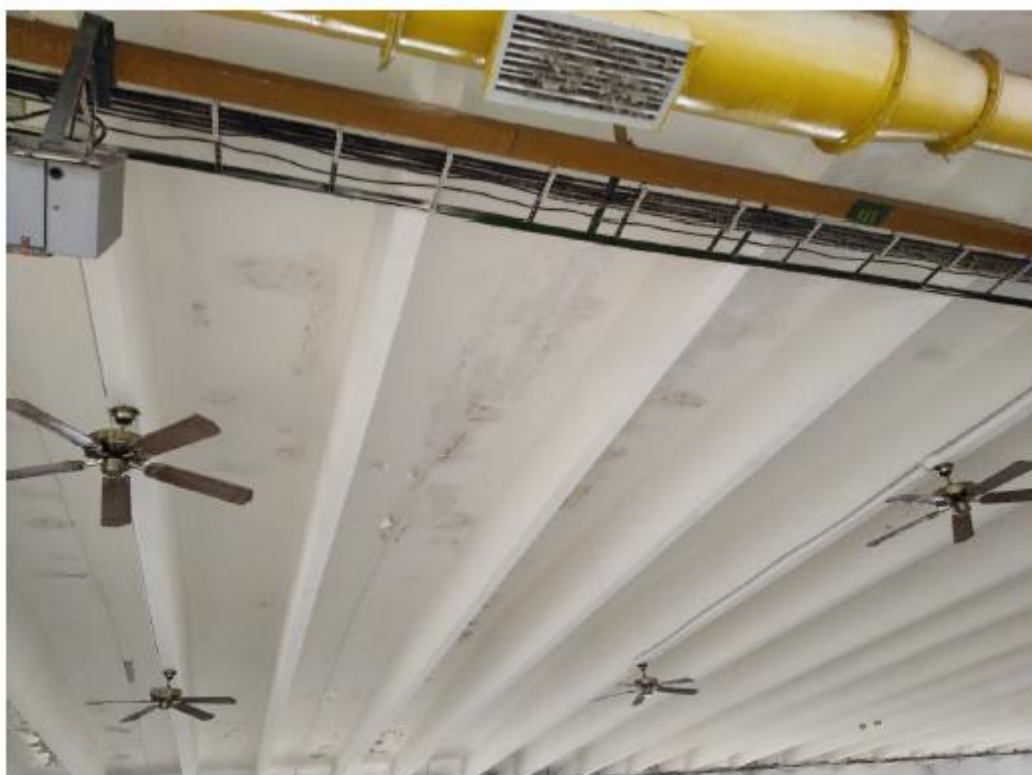
Původní vzduchotechnika doplněná o podstropné ventilátory
