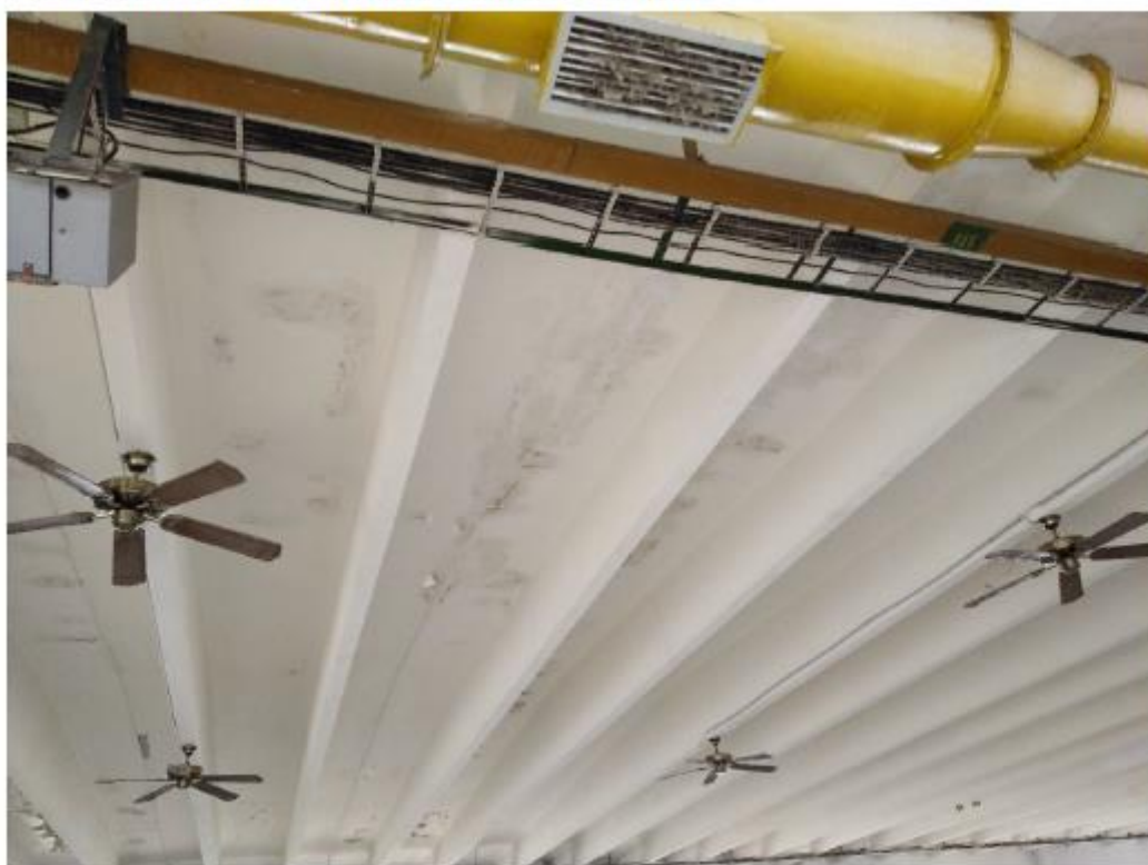
Původní vzduchotechnika doplněná o podstropné ventilátory
